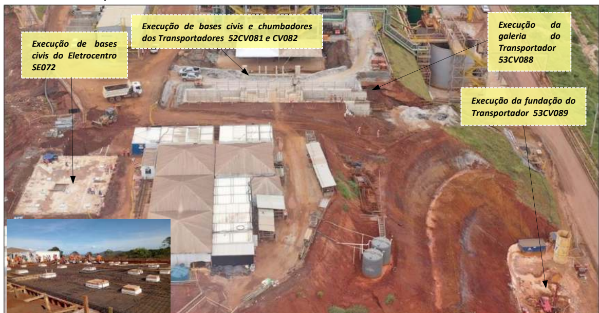
Foto 12: Exec. das Obras Civas – Fundações do 52CV081/ 082 e 53CV088 089 e Base do Eletrocentro SE072
