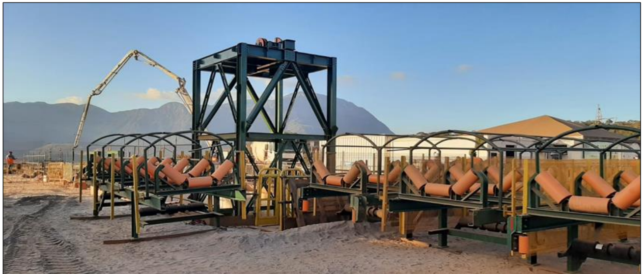
Foto 12 - Estruturas pré-montadas aguardando a execução das obras civis para a liberação p/ montagem
