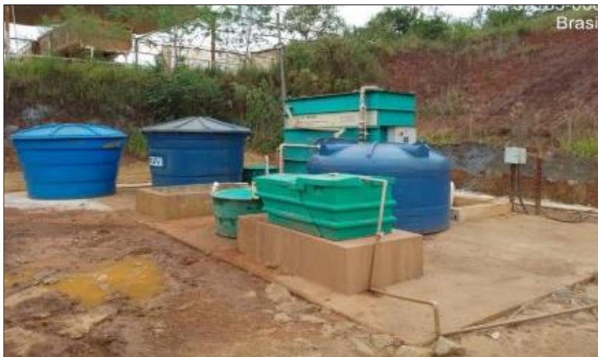
Figura 21: Caixa SAO Funcionando Normalmente
