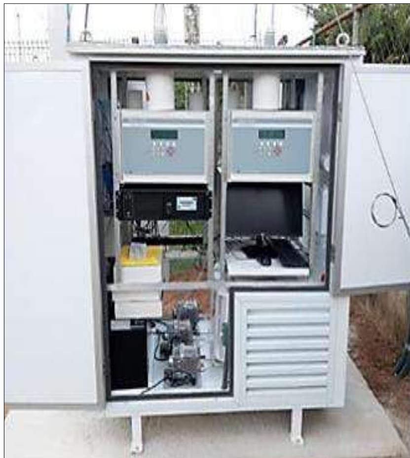
Figura 149: Detalhes dos Equipamentos da Estação de Monitoramento Santa Rita Durão
