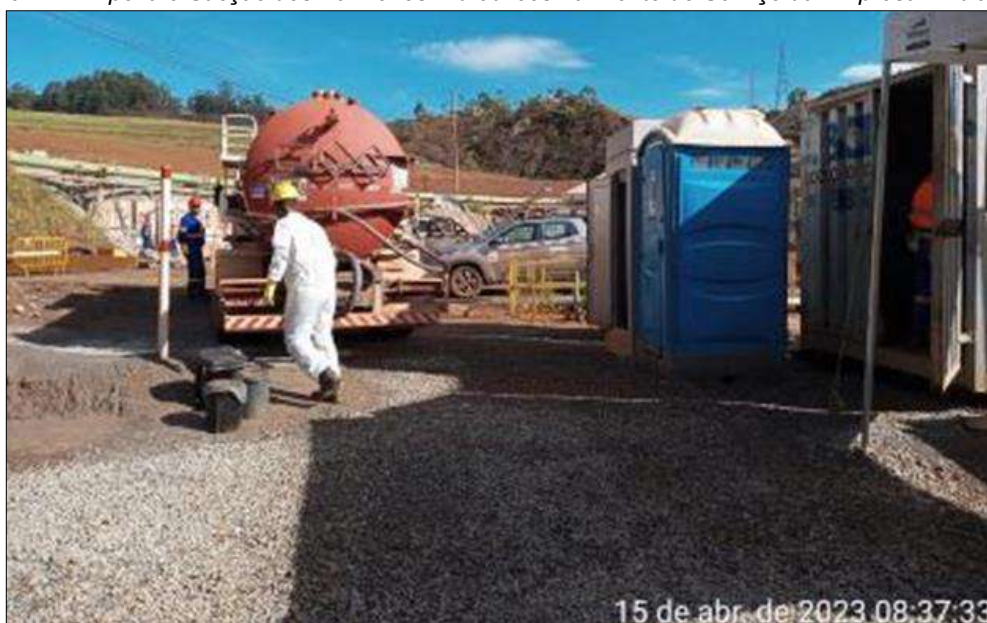
Figura 21: Limpeza e Sucção dos Banheiros Hidráulicos na Frente de Serviço da Empresa 'Entre Vias'
