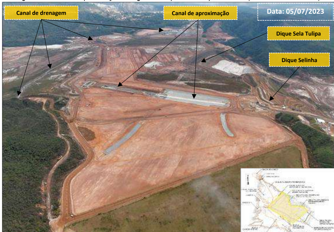
Figura 14: Canal de Aproximação e Região do Dique Sela Tulipa / Selinha (Obras em Andamento)
