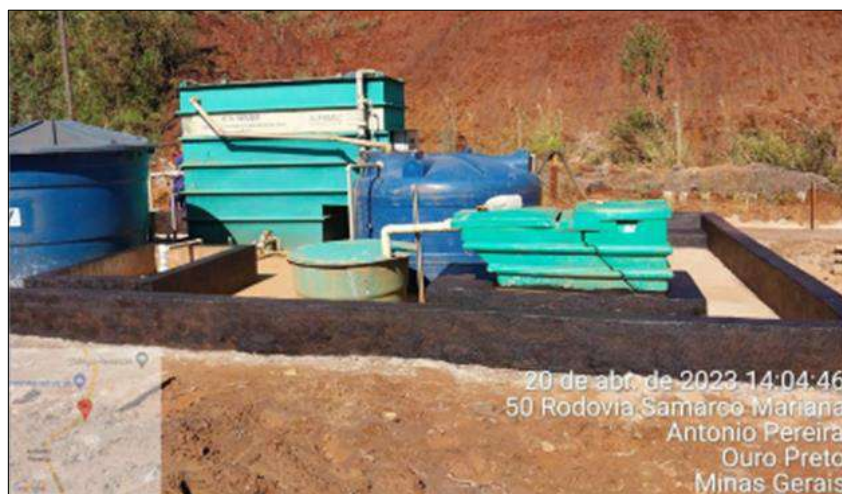
Figura 24: Caixa SAO Funcionando Normalmente na Oficina de Manutenção da Empresa 'MRF'
