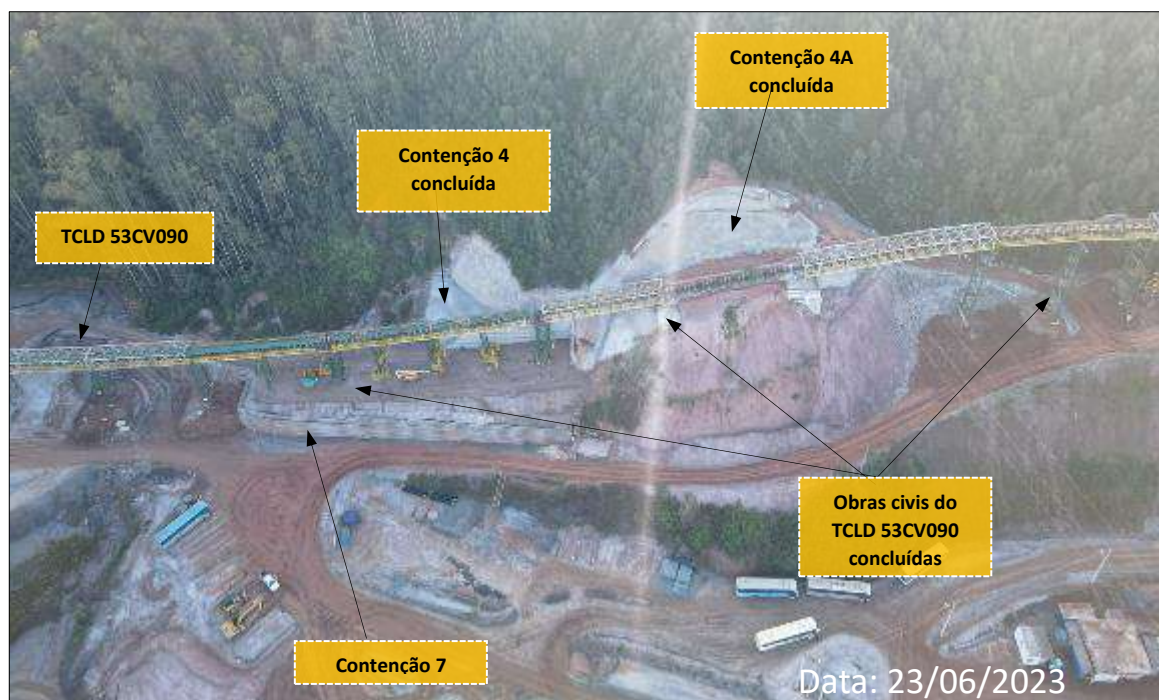
Foto 20: Montagem do TCLD 53CV090 e Obras Civas na Região do Pinheirinho Em Andamento
