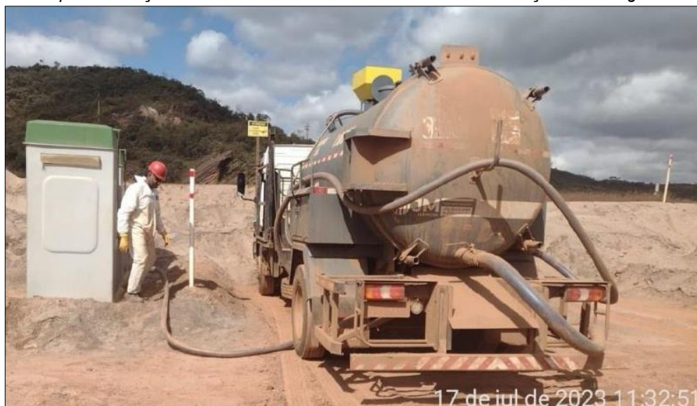
Figura 24: Limpeza e Sucção dos Banheiros Hidráulicos nas Frentes de Serviços da Barragem do Germano
