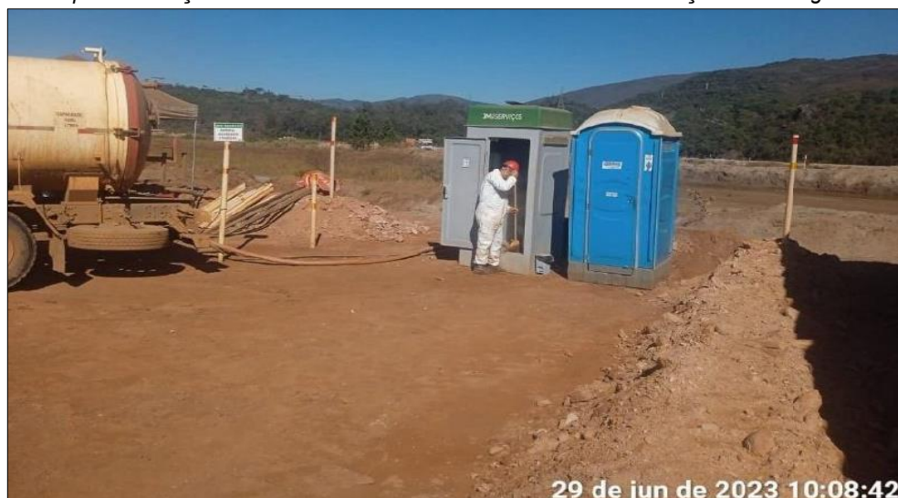
Figura 23: Limpeza e Sucção dos Banheiros Hidráulicos nas Frentes de Serviços da Barragem do Germano
