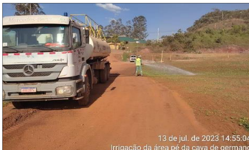
Figura 146: Monitoramento Ambiental – Irrigação
