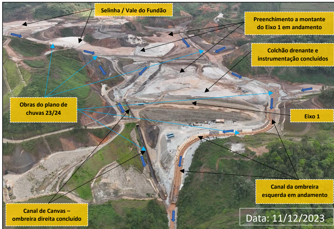
Foto 7: Vista do Eixo 1 – Obras de Preenchimento e Canal da Ombreira Esquerda em Andamento
