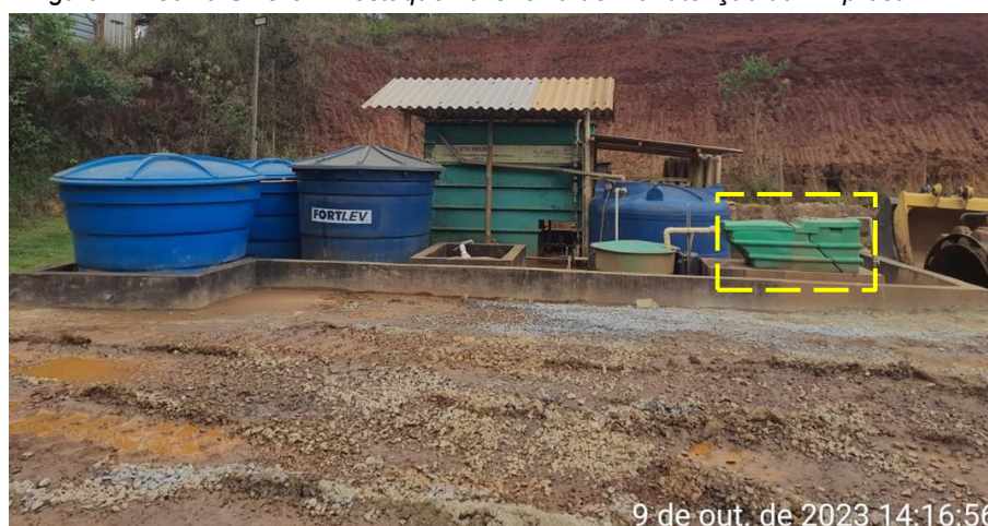
Figura 27: Caixa SAO em Destaque na Oficina de Manutenção da Empresa 'MRF'
