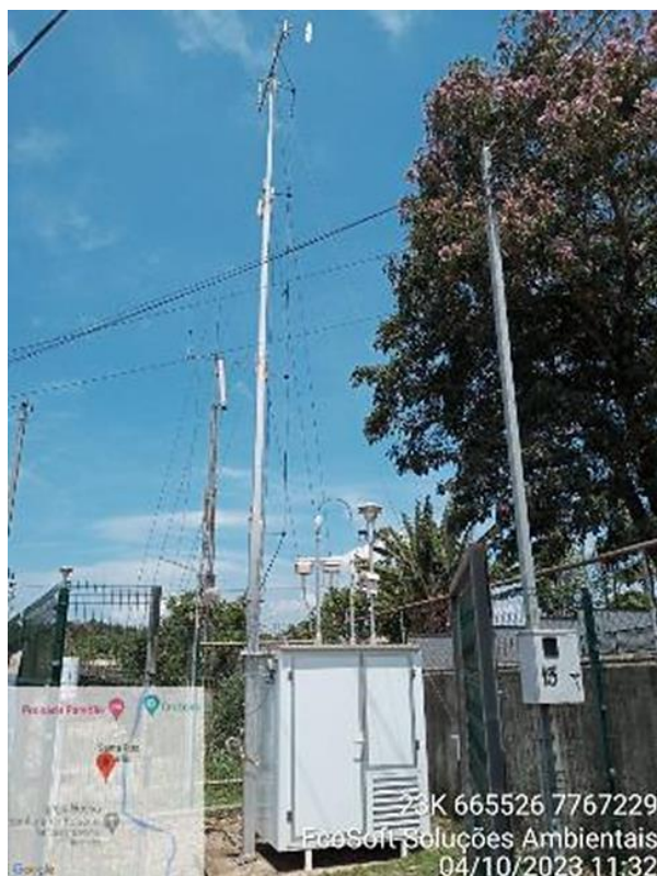
Figura 151: Vista da Estação de Monitoramento em Santa Rita Durão
