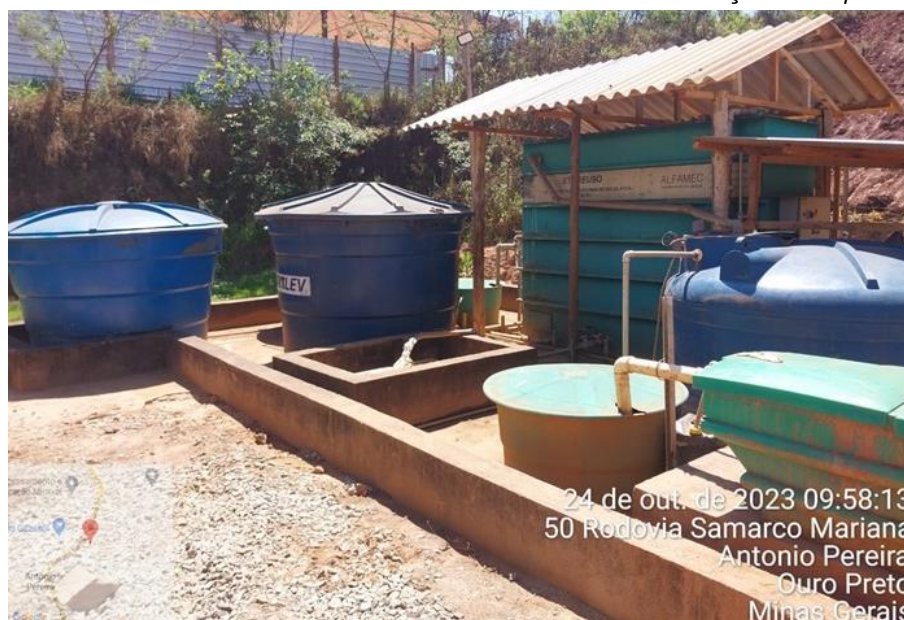
Figura 28: Caixa SAO Funcionando Normalmente na Oficina de Manutenção da Empresa 'MRF'
